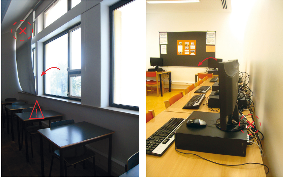
Figura 3. Ventanas y equipos electrónicos.
