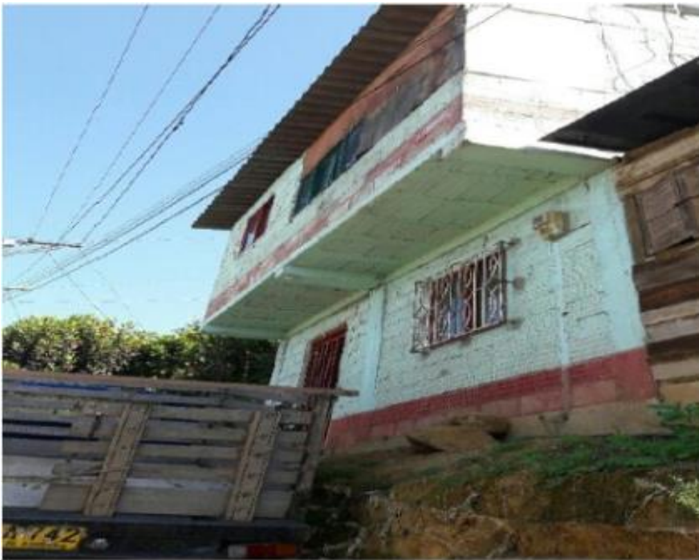
Figura 5. Ilustración de tipología de estructuras con confinamiento deficiente e híbridas(D). Ubicada en el municipio de Medellín. Tomado de EAFIT (2018). Convenio de asociación No. 4600076515 de 2018.
