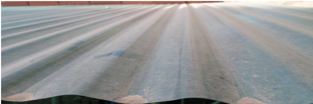
Imagen 15 Acumulación de sedimento en el área del techo
