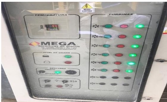
Foto 4: Tablero de medición
