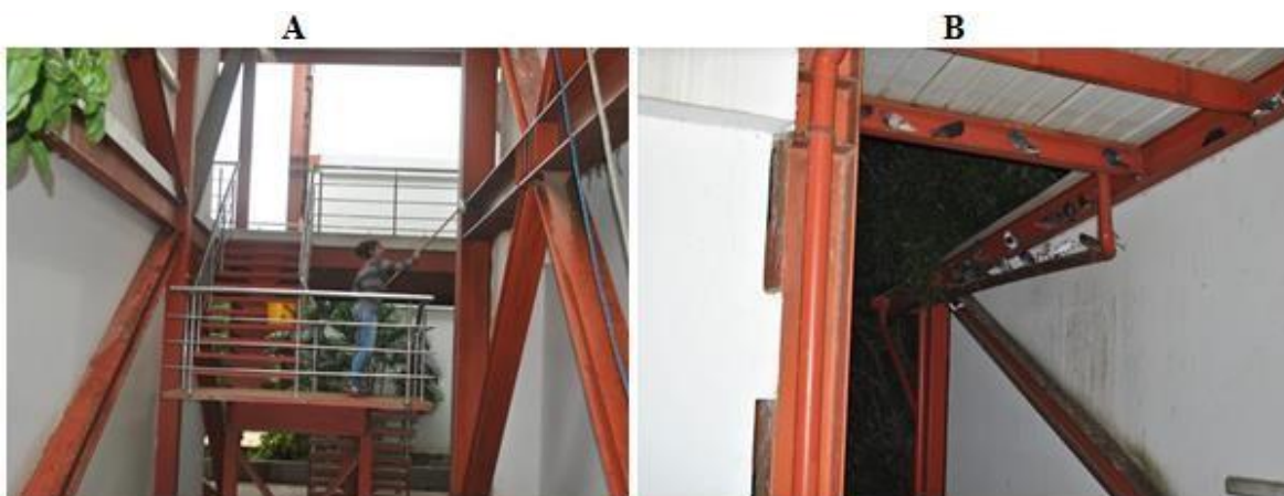
Figura 18. Área intervenida. A “Escaleras”, B “Parte superior infestadas por palomas” Fuente: Los autores
