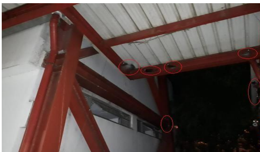
Figura 12. Área de biblioteca costado superior con presencia de palomas al caer la noche. Fuente: Los Autores
