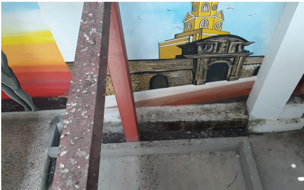
Figura 1. Presencia de Materia Fecal de Palomas en el Piso y Estructura Metálica del Primer Piso del CCAV Cartagena. Fuente: Los autores.
