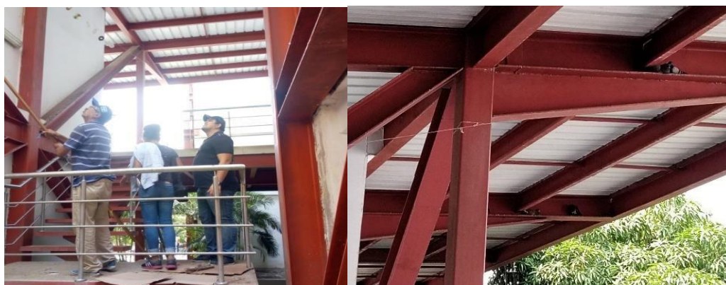
Figura 11. Área de biblioteca y escaleras afectada por la presencia de aves. Fuente: Los Autores
