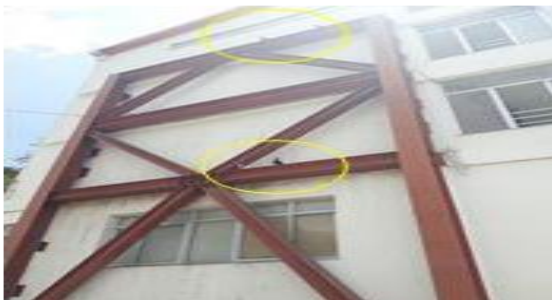
Figura 4. Presencia de Anidado en Estructura Metálica Ubicado en Costado Sur. Fuente:
