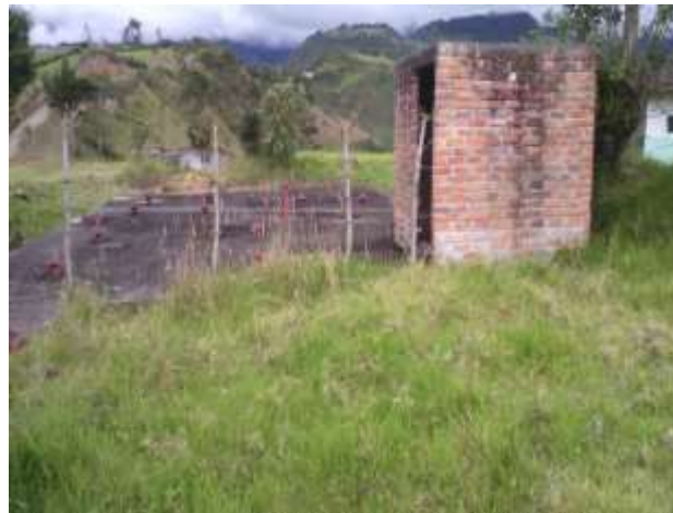
Figura 20 Imágenes Tanque de almacenamiento
