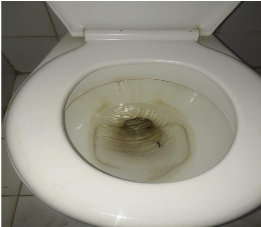
figura 15. Sanitario con falla en descarga. Elaboración propia.
