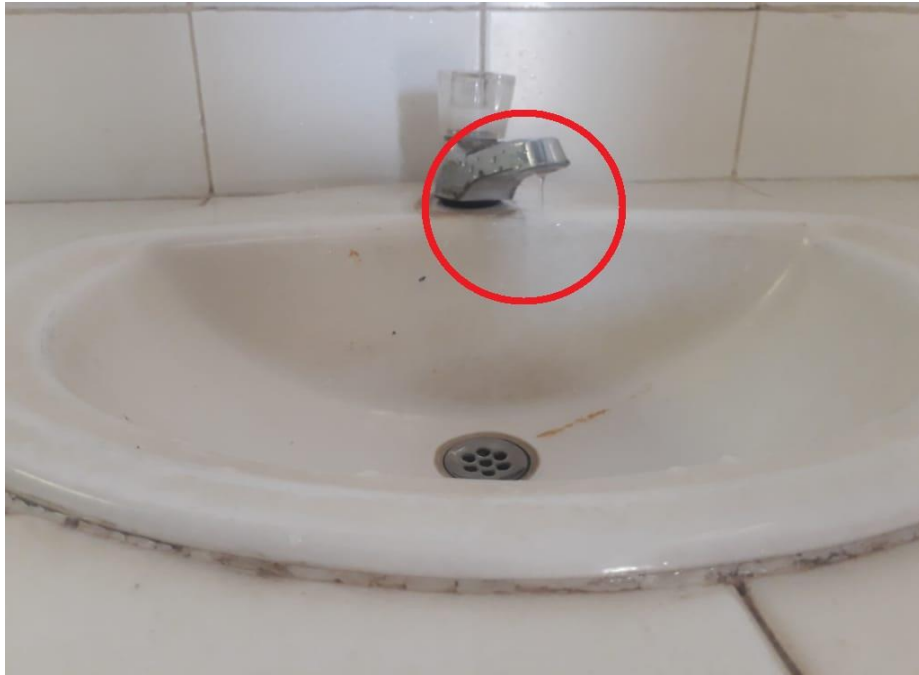
figura 14. Lavamanos en mal estado. Elaboración propia
