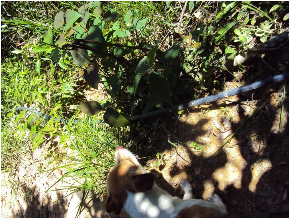
Cardona, M. (2016) Manguera del acueducto Estación uno [Figura 26]
