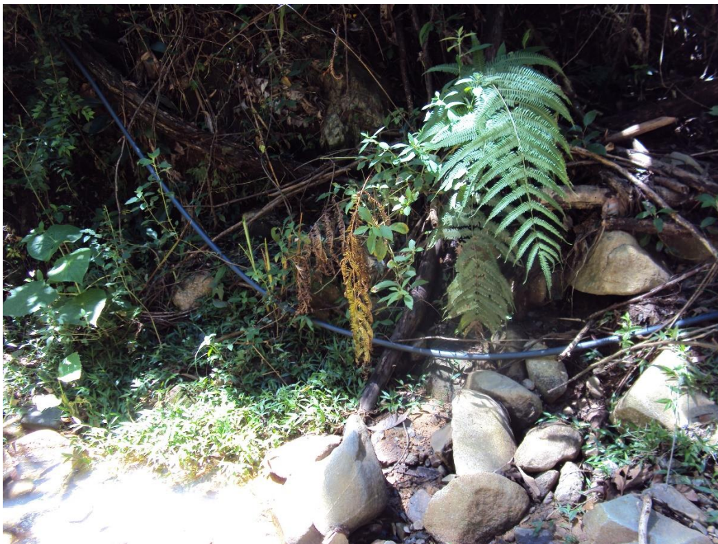
Cardona, M. (2016) Manguera del acueducto Estación dos [Figura 27]
