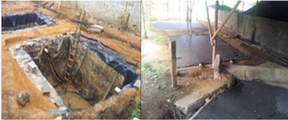
Figura 23. pozos en tierra que remplazan los sistemas en pvc
