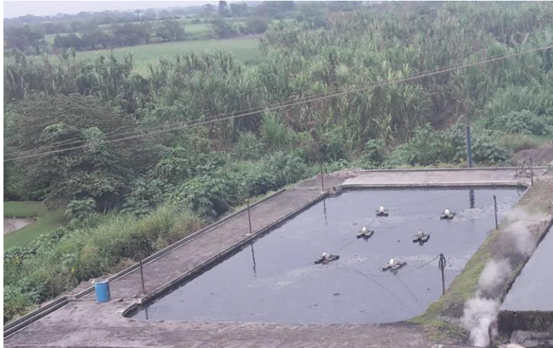
Imagen 8. Laguna de aireación de la PTAR del trapiche Lucerna 2016. Fuente: Elaboración propia.
