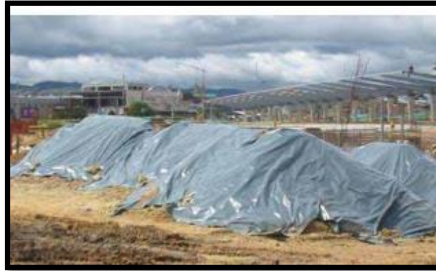
Figura 10. Material pétreo cubierto con plástico evitando polución por aire y contaminación por arrastre de material en días de lluvia
