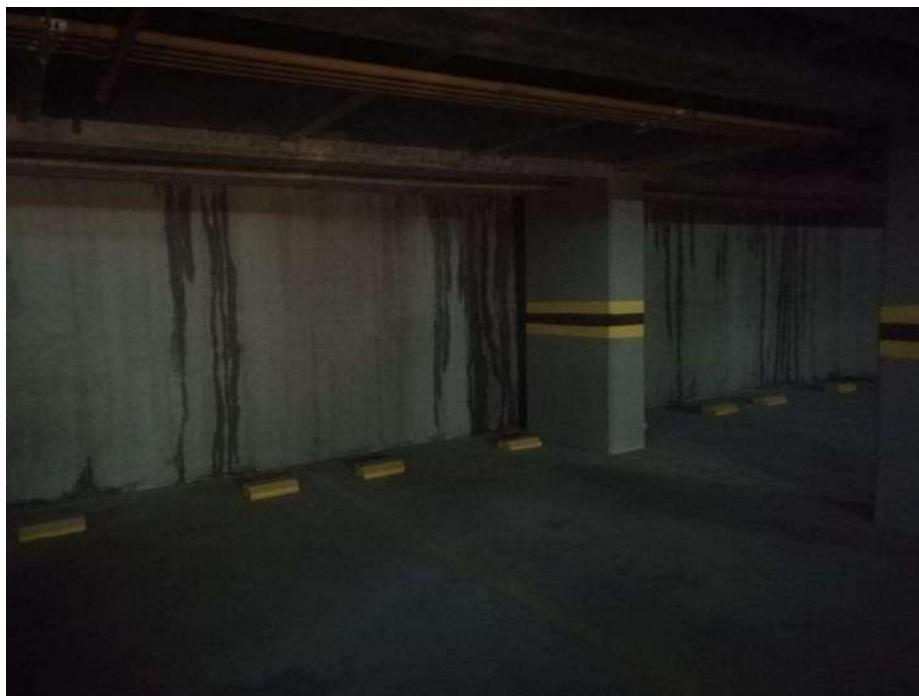
Humedad presentada en los sótanos del conjunto
