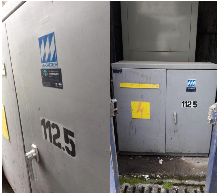
Ilustración 18 Transformador sede principal Aguas de Manizales S.A. E.S.P. fuente propia del investigador 2019.
