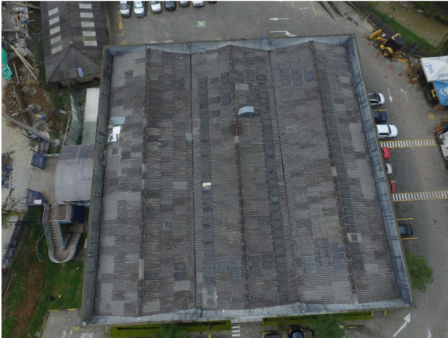
Ilustración 12 Cubierta edificio central administrativo sede principal Aguas de Manizales S.A. E.S.P. fuente proceso de administración logística 2019.
