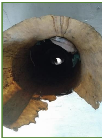
Imagen 17. Afectaciones en los ductos
