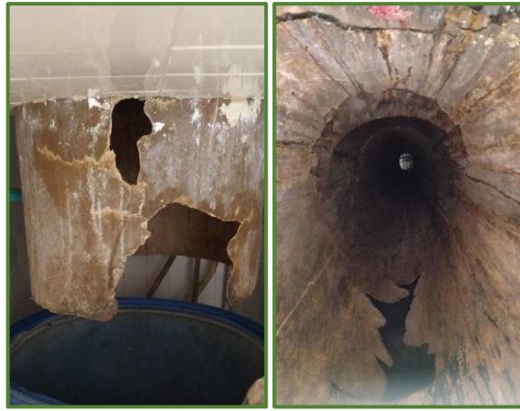
Imágenes 15 y 16. Estado de los ductos
