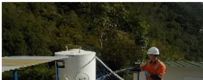
Anexo 6. Aseo general planta de tratamiento de aguas residual doméstica.
