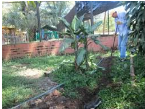
Aldana, K., González, J., Macias, F., (c. 2013). "Instalación de la manguera para el suministro de agua." (Fotografía). Universidad Nacional Abierta y a Distancia. Acacias (Meta).
