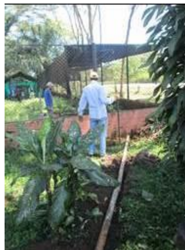
Aldana, K., González, J., Macias, F., (c. 2013). "Disposición bajo tierra de las conexiones para su efectivo funcionamiento." (Fotografía). Universidad Nacional Abierta y a Distancia. Acacias (Meta).
