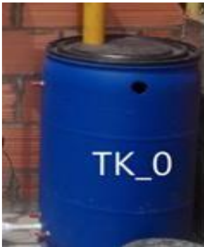
Figura 17 Tanque de recolección primario de agua lluvia
