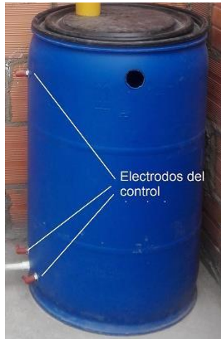
Figura 33 Tanque Recolecto de agua lluvia primario
