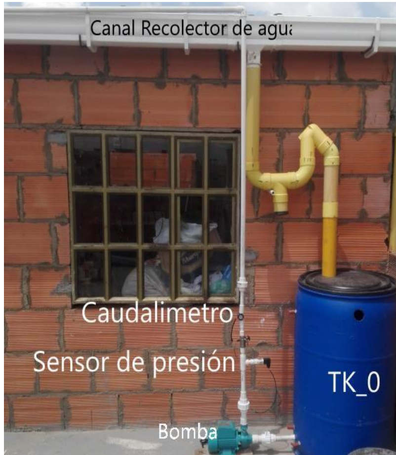
Figura 29 Descripción física del sistema recolector agua lluvia
