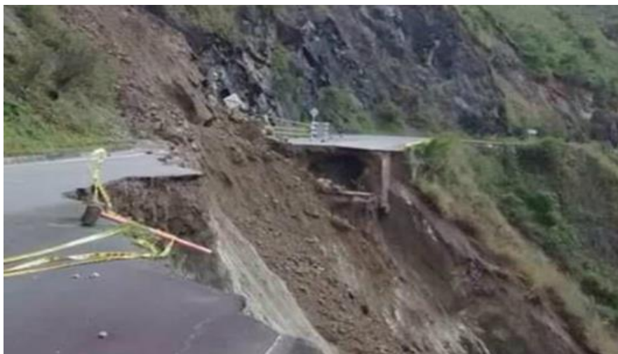
Figura 18. Registro Fotografico Derrumbes via Chitagá – Pamplona (Julio 2015)
