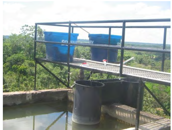
Ilustración 57. Tanques de floculación del acueducto municipal
