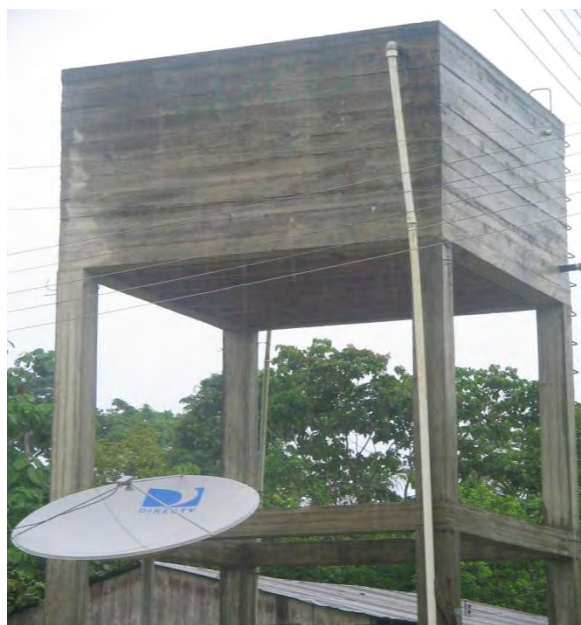
Ilustración 53. Tanque de almacenamiento
