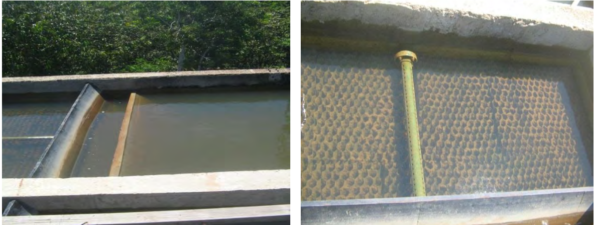
Ilustración 58. Sedimentadores del acueducto municipal
