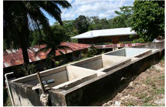
Tanque de almacenamiento de 8600 litros
