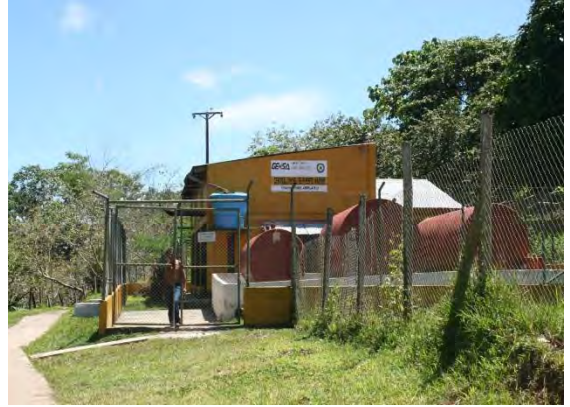
Tanques de almacenamiento de aguas lluvias
