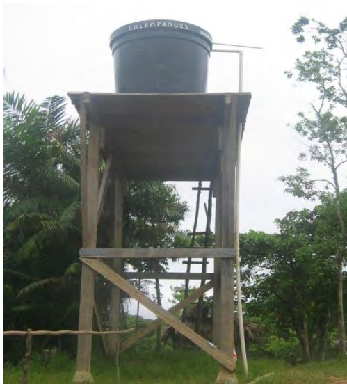
Ilustración 48. Pacera o Tanque de almacenamiento
