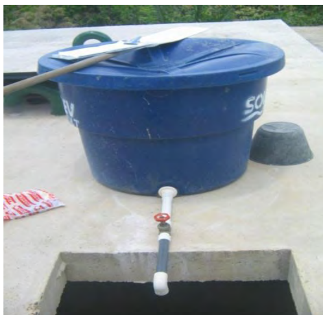
Ilustración 61. Dosificador de cloro
