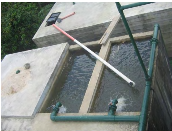
Ilustración 59. Vista general del filtro del acueducto municipal
