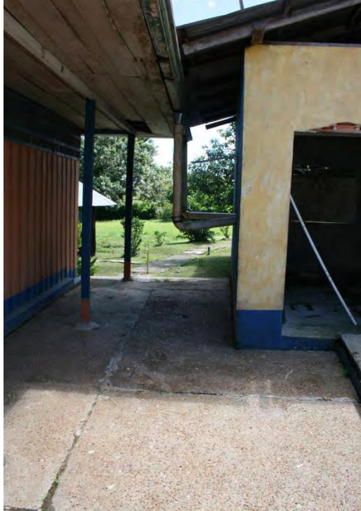
Aprovechamiento de aguas lluvias conectado a tanque subterráneo
