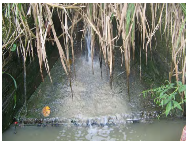
Ilustración 71. Vertimiento puntual de agua residual
