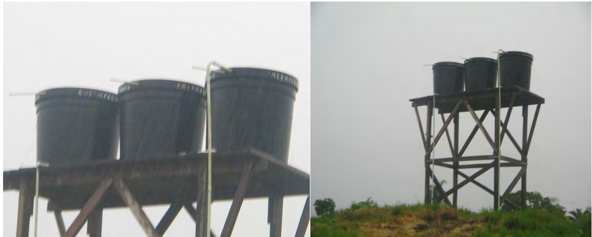
Ilustración 52. Pacera o Tanque de almacenamiento
