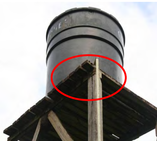
Ilustración 51. Base de la pacera afectada por el comejen
