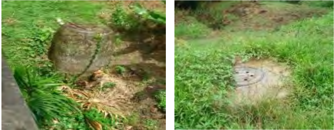
Ilustración 66. Pozos de inspección del alcantarillado
