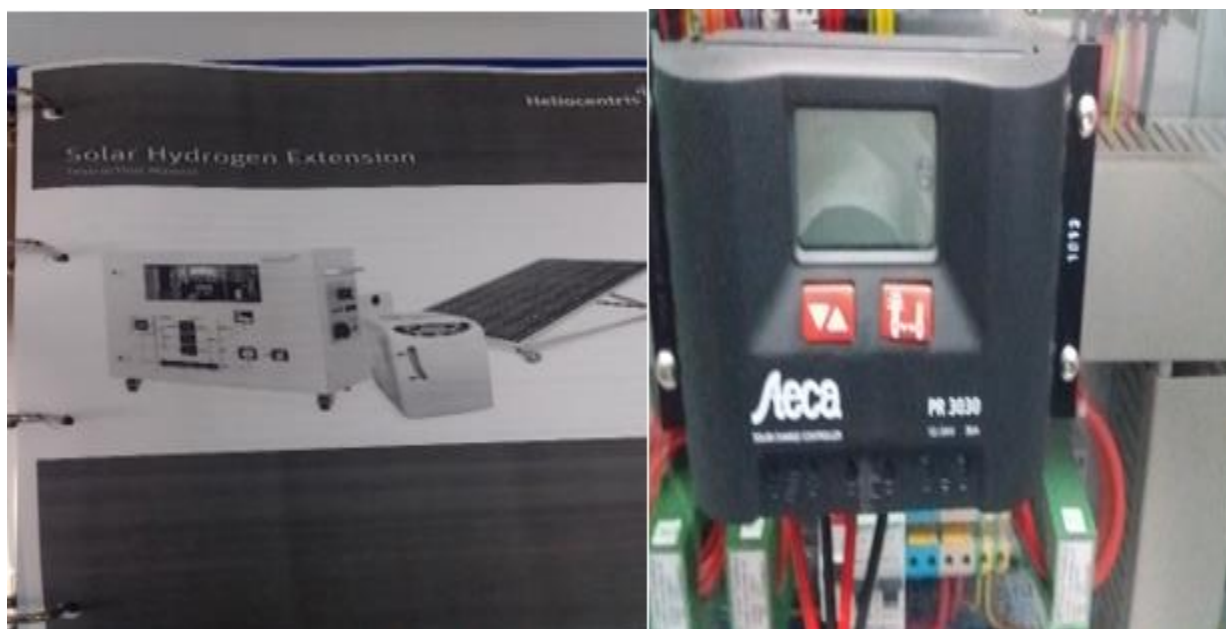
Figura 21 Manual operación y regulador carga. Fuente: Propia
