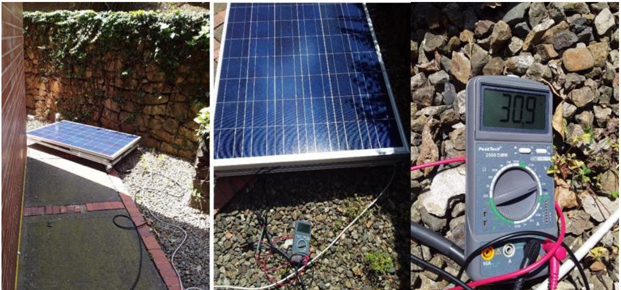
Figura 12 Medida voltaje zona exterior instalaciones. Fuente: Propia
