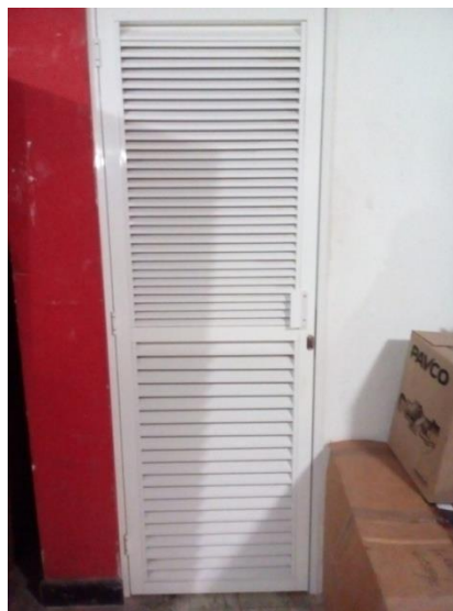
Figura 11. Puerta de entrada para el centro de datos.
