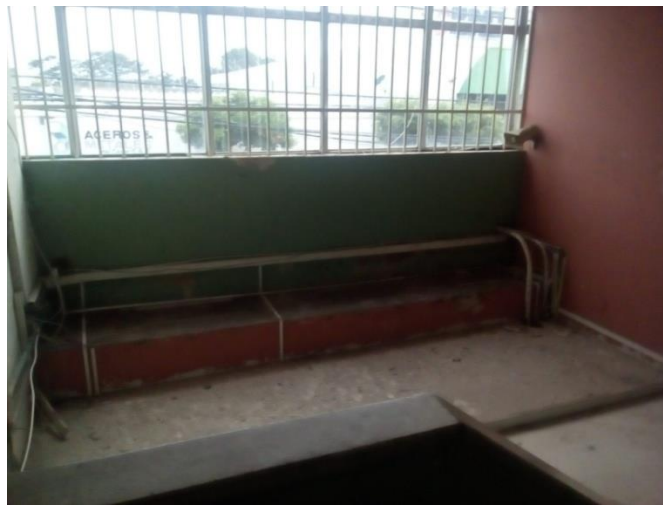
Figura 9. Contaminación medio ambiental del cableado de datos
