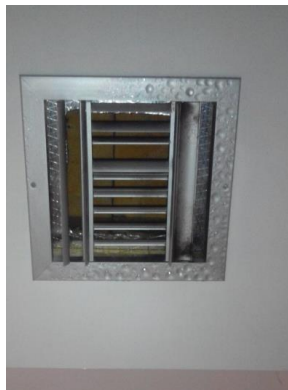
Figura 13. Rejilla del aire acondicionado sobre los equipos informáticos
