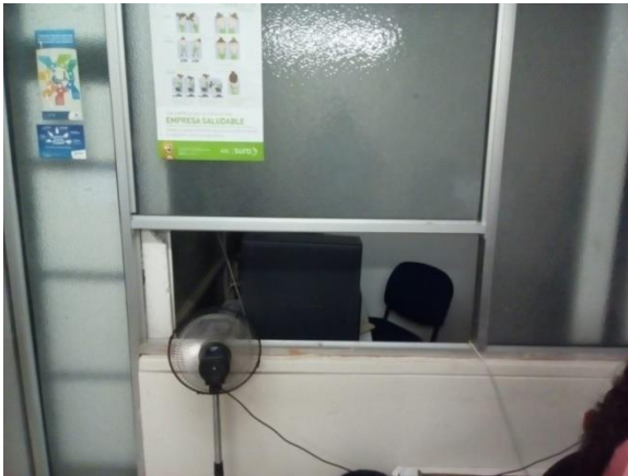
Figura 10. Sistema de refrigeración y ventana de acceso del centro de datos
