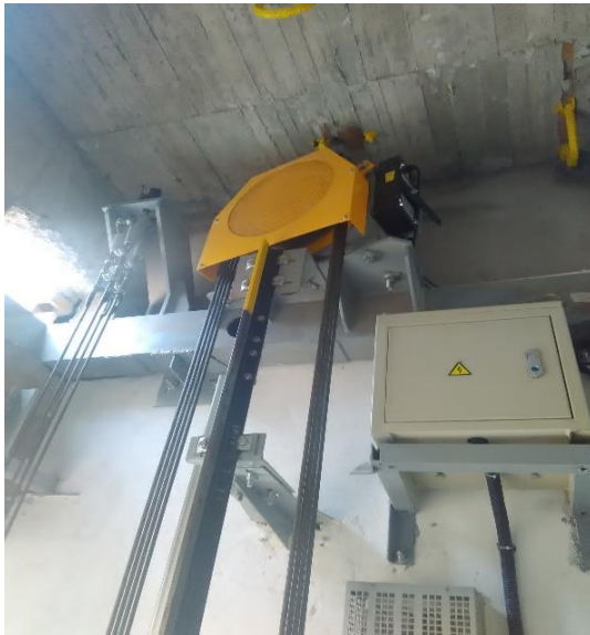
Sistema con máquinas internas dentro de pozo Foto obtenida en campo (autoría propia)
