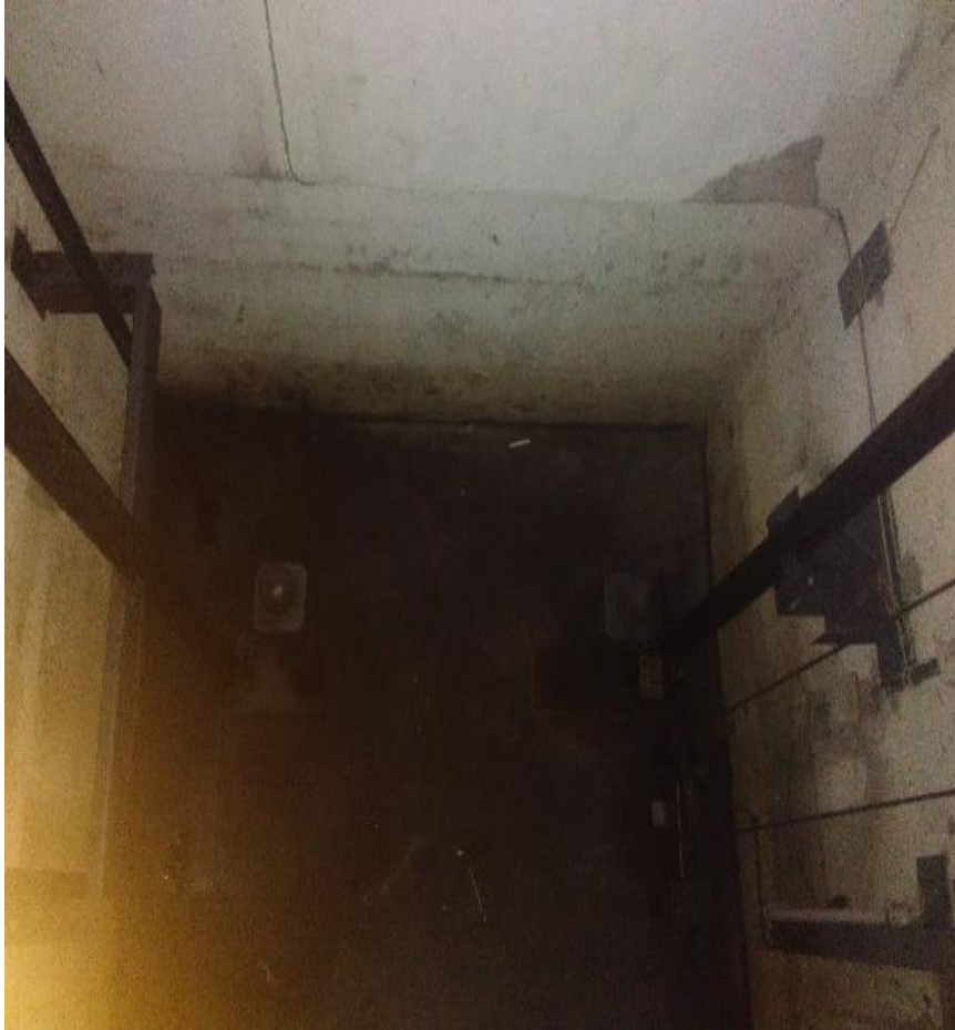
Ilustración 10 Pozo Foto obtenida en el campo (fuente propia)
