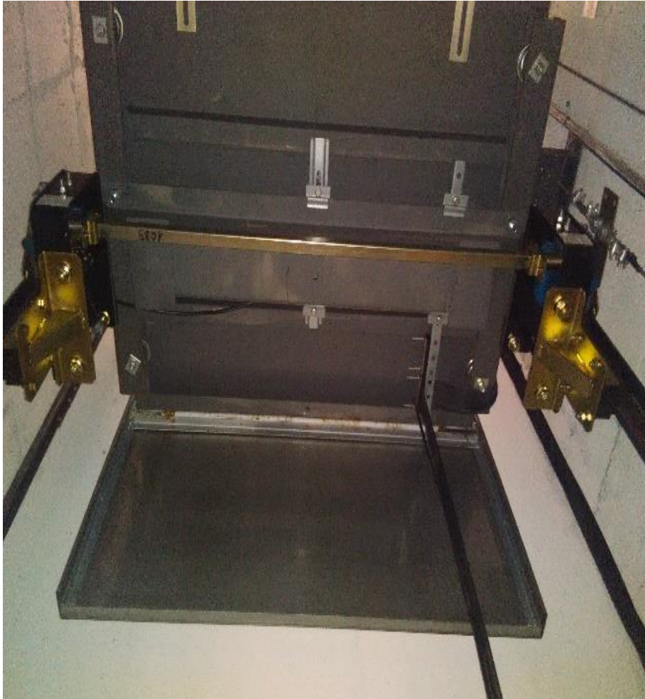
Ilustración 13 Sistema de Seguridad
