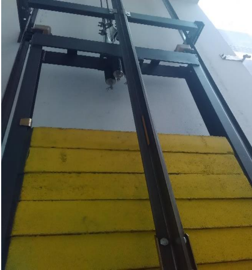
Ilustración 12 Contrapeso Foto obtenida en el campo (fuente propia)
