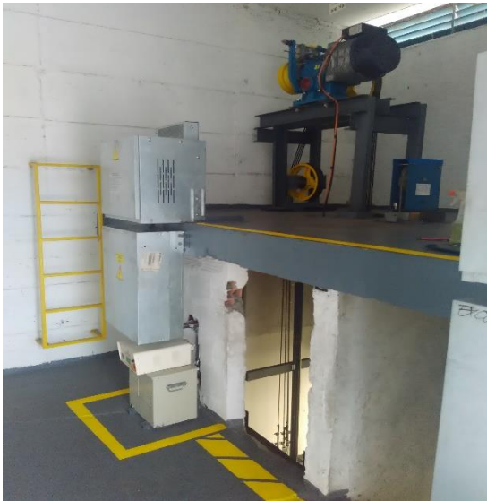
Equipo con cuarto de máquinas parte superior del pozo Foto obtenida en campo (autoría propia).
