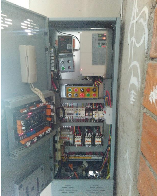
Control de ascensor ubicado en el último piso en el pasillo. Foto obtenida en campo (autoría propia).
