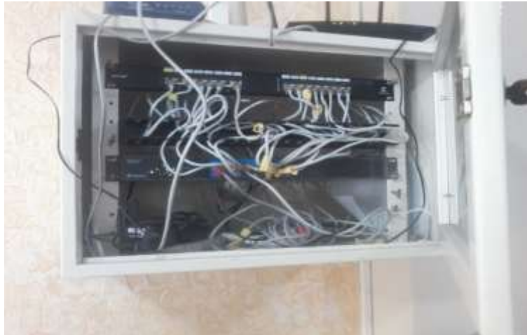
Figura 7. Gabinete de pared
