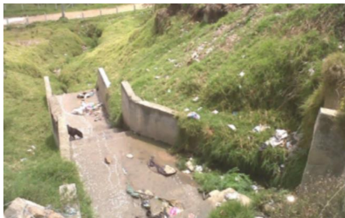
Figura 4: Disposición inadecuada de residuos sólidos
