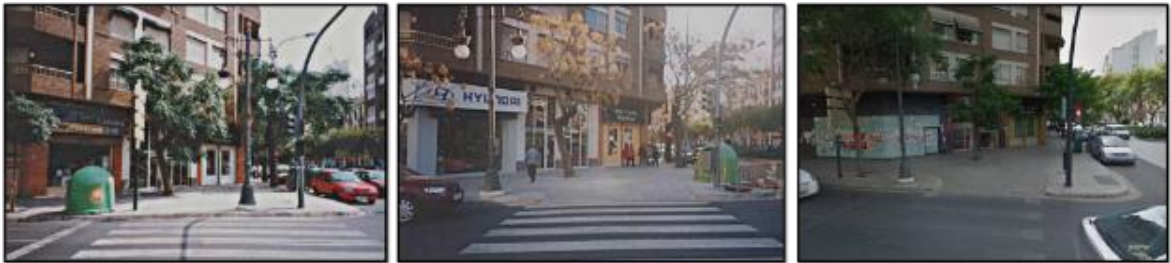
Ilustración 28. Obras de acondicionamiento de paso peatonal en Calle Maestro Sosa de la ciudad de Valencia.
