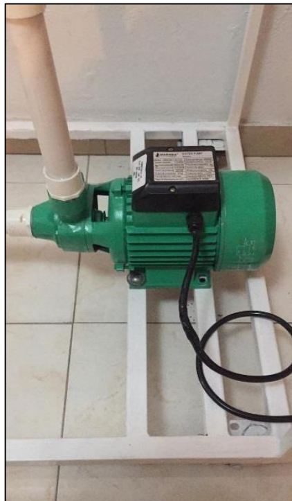
Ilustración 25. Ubicación de la bomba en la estructura.
