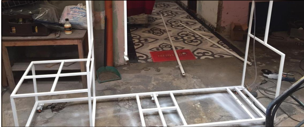
Ilustración 24. Acabados para la estructura de fijación del equipo.
