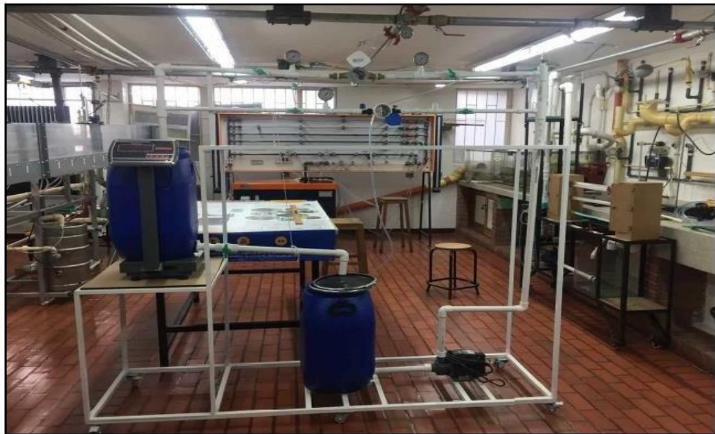
Ilustración 10. Estado actual del banco de medidores.
