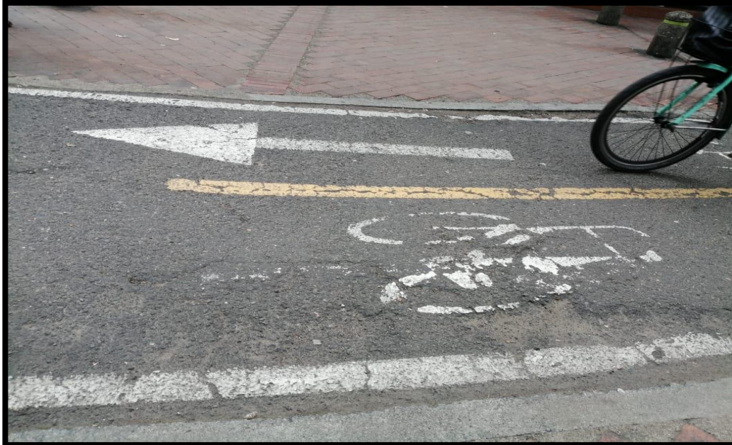
Figura 18. Demarcación Horizontal de la cicloruta deteriorada
