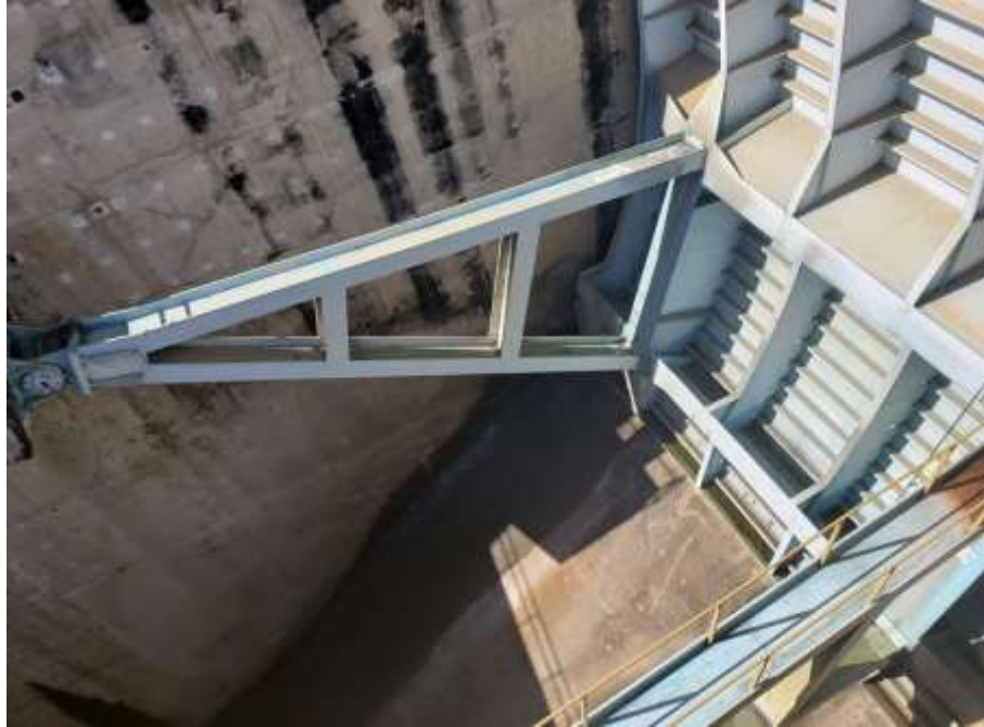
Figura 18 Compuerta Hidráulica tipo oruga
