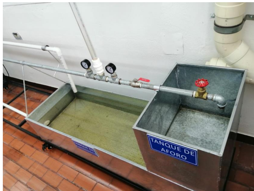
Figura 9. Tanque de aforo de caudal
