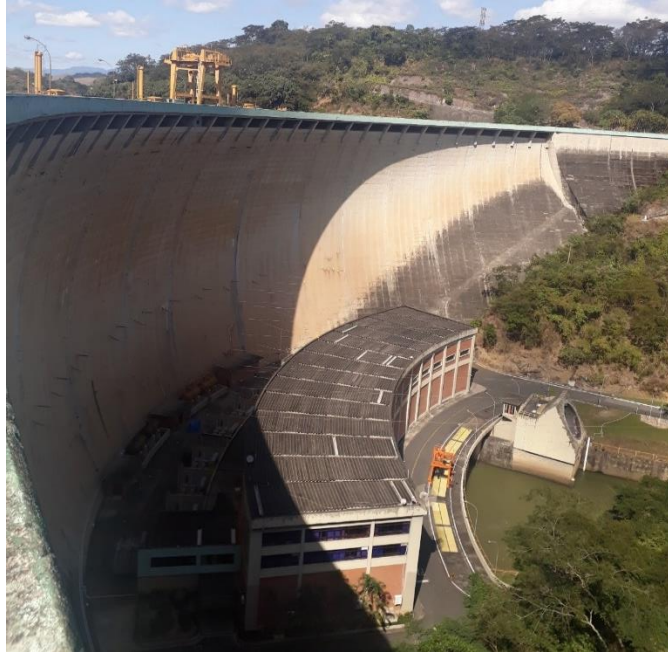
Figura 15. Presa y Sala de control y operación
