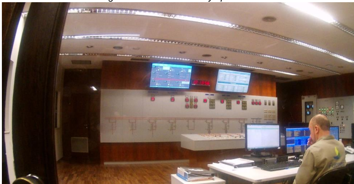
Figura 14. Sala de control y operación
