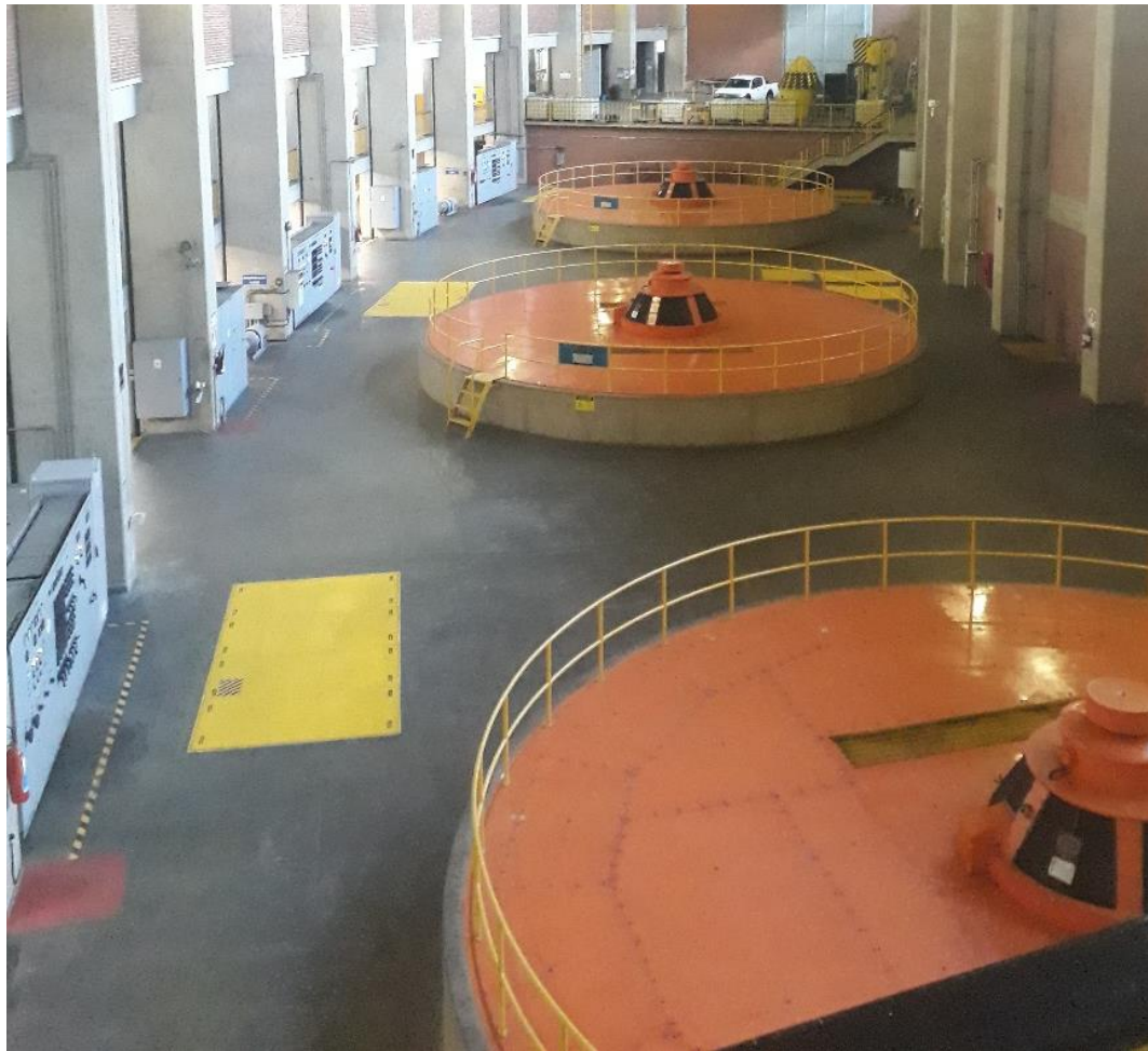
Figura 12. Casa de máquinas central Hidroeléctrica Funil Furnas Brasil – Turbinas y tableros de comando
