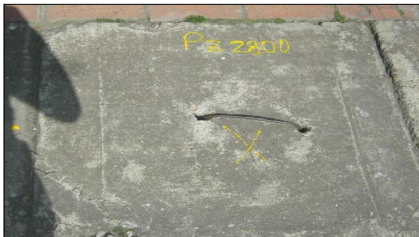
Ilustración 28. Cámara de inspección con tapa partida.
