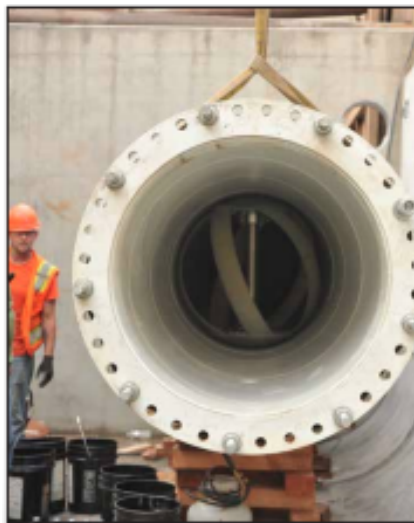
Gráfica 17 Instalación LucidPipe en Portland, Oregon
