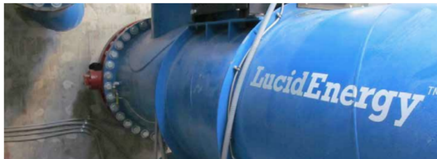
Gráfica 18 Instalación LucidPipe en Riverside, California
