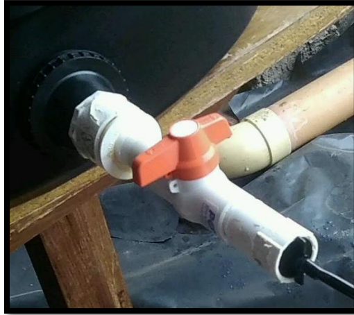
Figura 34 Tubería de 1/2" pulgada y llave de paso
