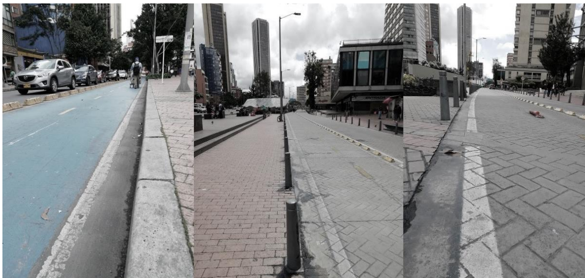
Gráfico 26. Ausencia de drenajes de aguas lluvia sobre la totalidad del recorrido de la cicloruta. Fuente: Toma propia. (2019)
