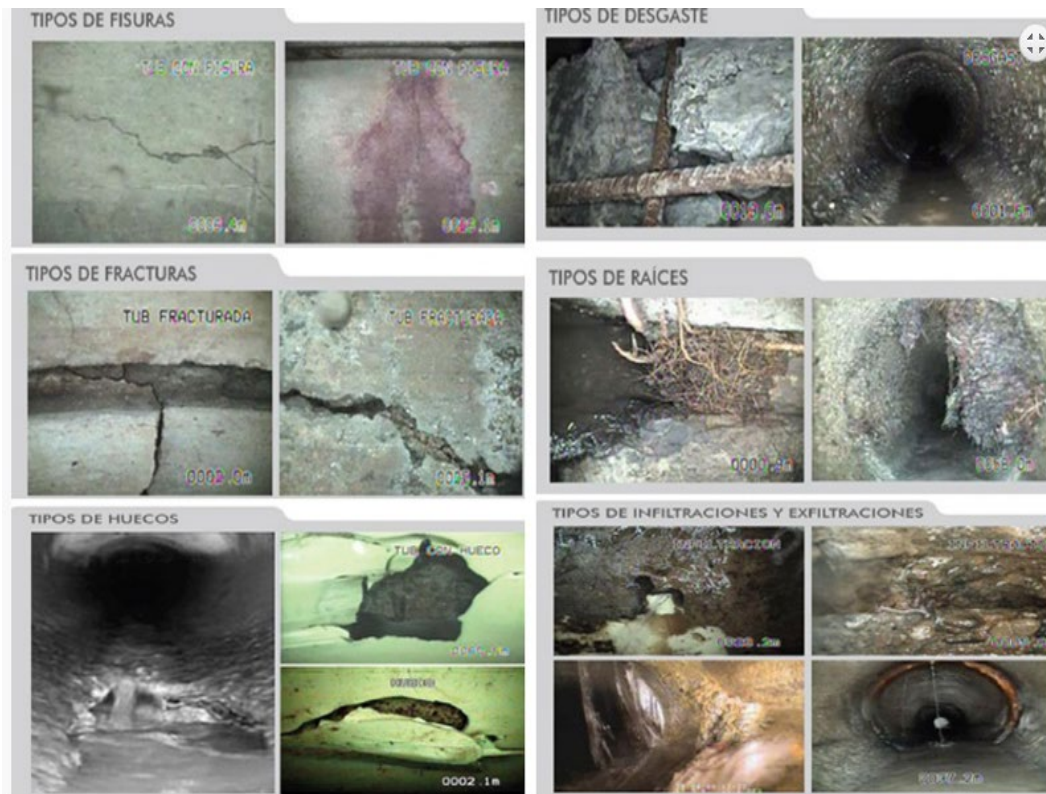
Figura 3. Problemas Redes del Alcantarillado en Bogotá.
