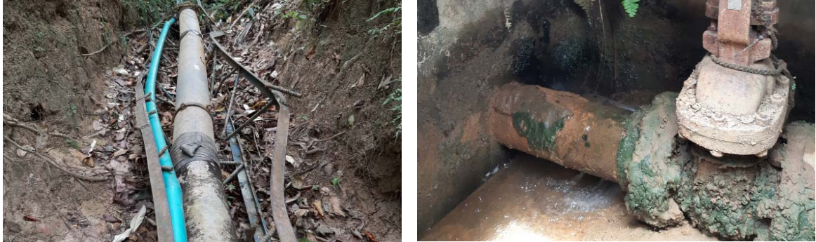
Figura 16. Fallas en la línea de aducción.
