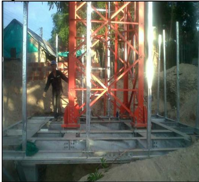
Figura 16. Torre tipo celda portátil
