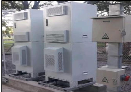
Figura 11. Conjunto de equipos de potencia, fuerza y clima
