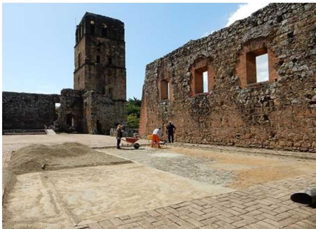
Figura 4.1. Área inicial en el interior de la Catedral, sin los adoquines, la arena de nivelación y el geotextil que cubría el piso.
