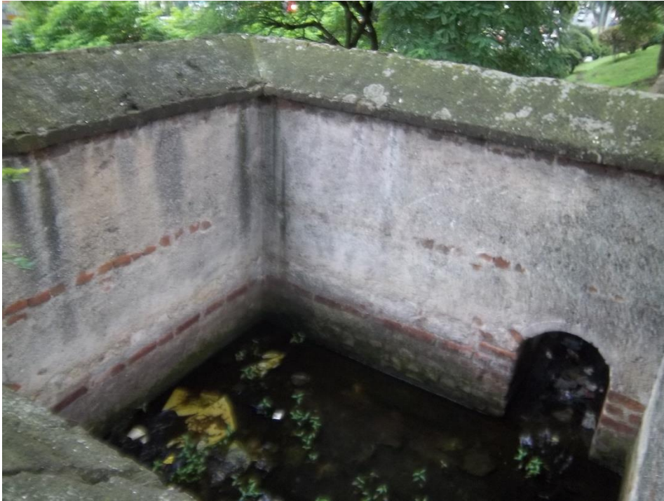
Imagen 68. Interior de un caja o arca desarenadora y redistribuidora, trabajo de campo. 1314
