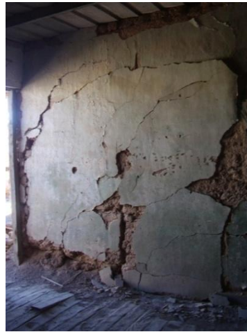
Desplome y desprendimiento de revoques
