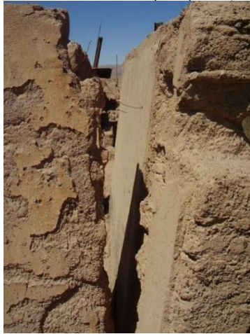
Grietas en muros de adobe, 2009
