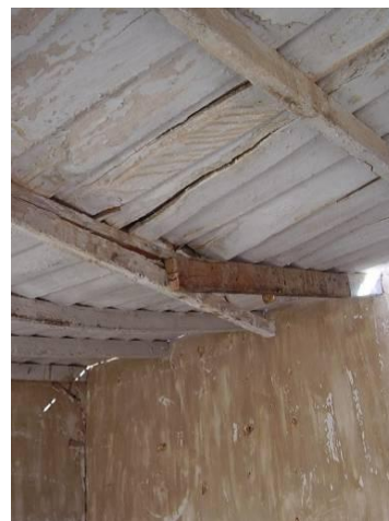
Fracturas de techumbres, 2009
