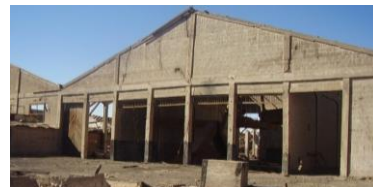
Casa de Máquinas, 2008
