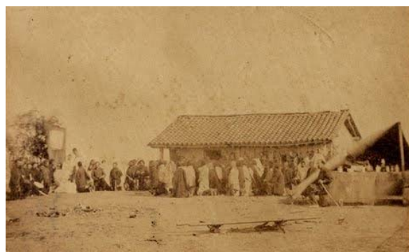
FIGURA 5. Fotografía de autor anónimo. Momento de la demolición de la casa del Gobernador. Colección de Javier Yubi. Paraguay
