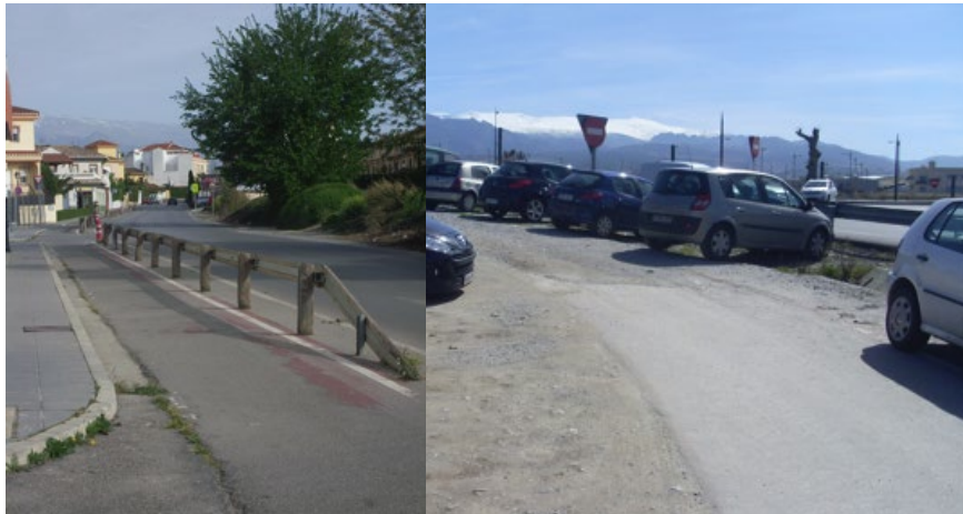
Carriles bici con falta de mantenimiento. Fuente: Imagen propia
