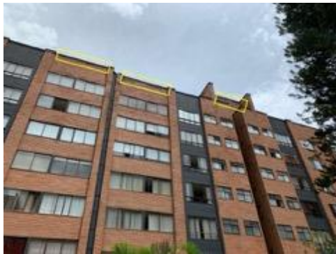
Ilustración 39. Fisura en ménsula VR.
