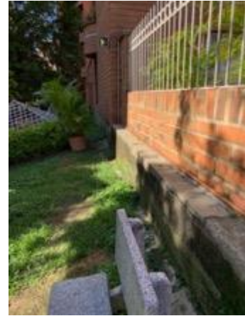
Ilustración 33. Humedades en fachada SMO.
