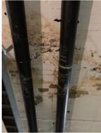
Ilustración 31. Humedades en losa SMO.
