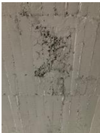
Ilustración 28. Hormiguo en losa SMO.
