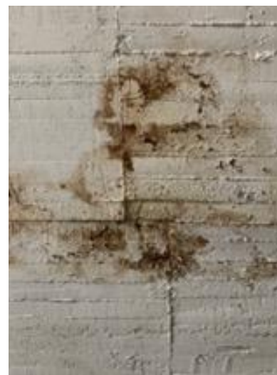
Ilustración 30. Humedades en losa SMO.
