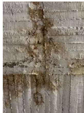
Ilustración 29. Humedades en losa SMO.
