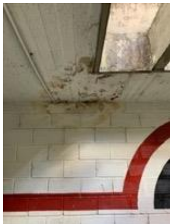
Ilustración 27. Humedades en losa SMO.
