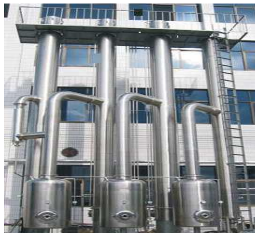
Figura 10: conjunto de evaporadores multi-efecto
