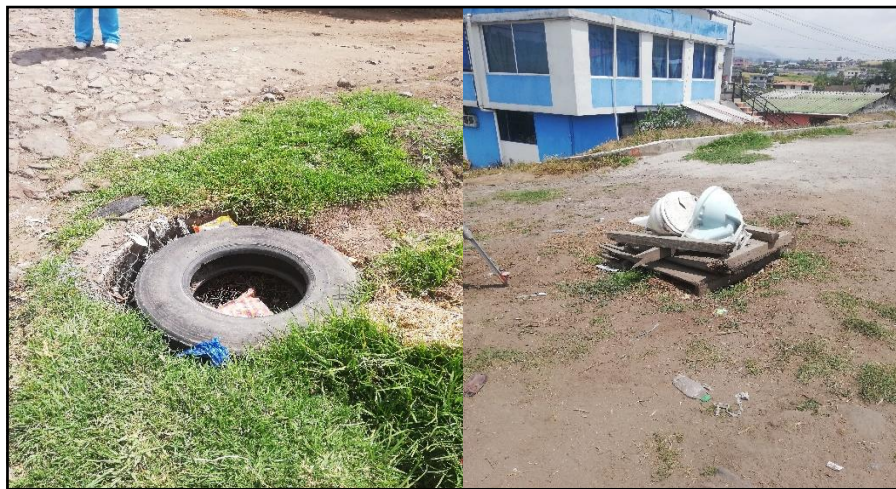
Figura 20. Falta de tapas de hierro fundido en los pozos de revisión.
