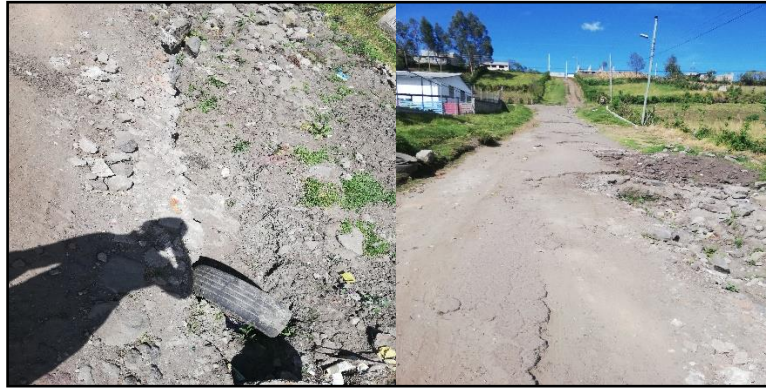
Figura 19. Colapso de la tubería de alcantarillado sanitario-hundimiento de tierra.
