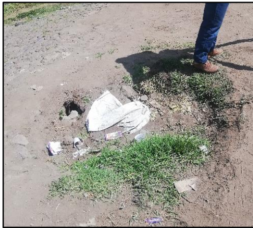
Figura 18. Mal mantenimiento del pozo de revisión.
