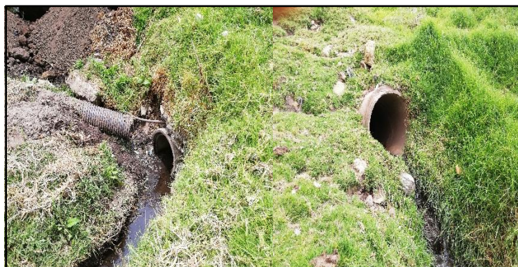
Figura 21. Descargas de aguas servidas en dirección a la quebrada Jalupana.
