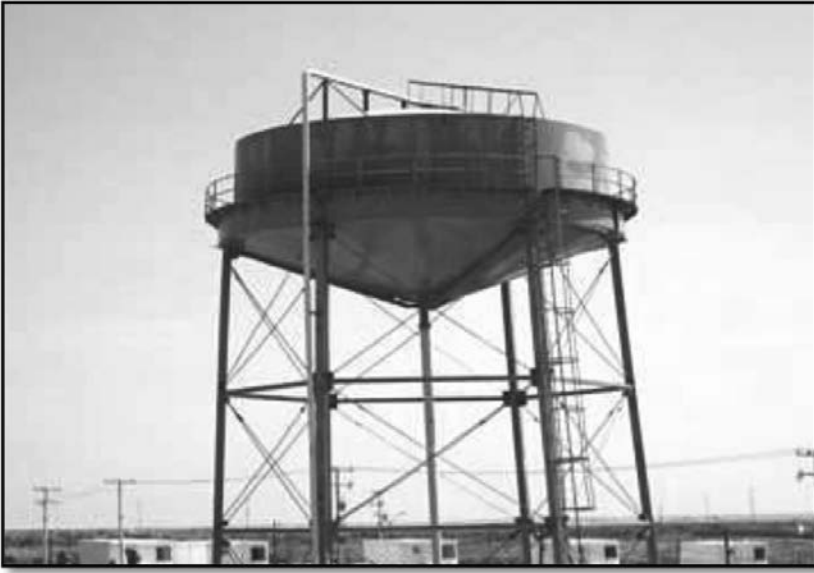
Figura No. 9. Tanque de almacenamiento de agua
