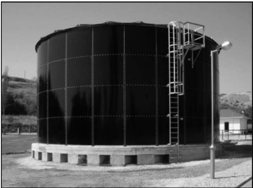
Figura No. 8. Tanque de almacenamiento de agua
