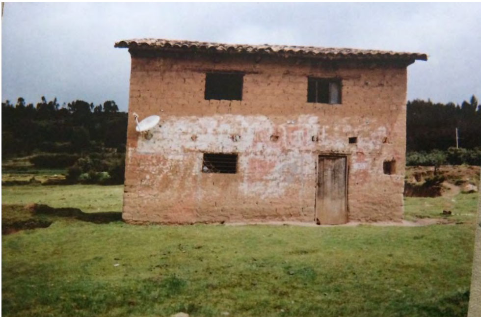
Imagen 17: Ejemplo de una casa muy poco valorada debido al abandono y ausencia de mantenimiento en los acabados. Esta casa está en desuso. Foto: Walter Illa
