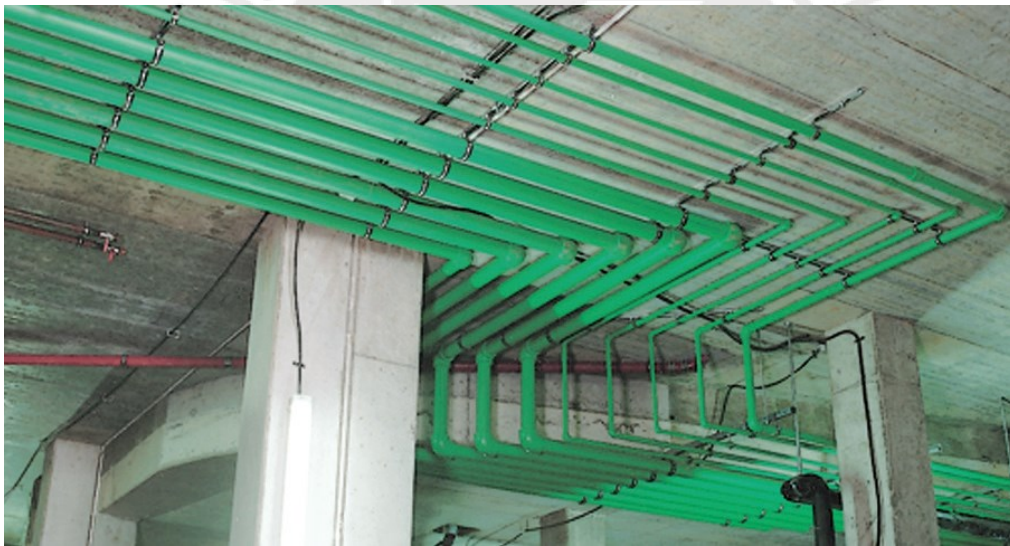
Figura 3.2 Sistema de tuberías de PP-R ancladas a losas (Aquatherm, 2015).
