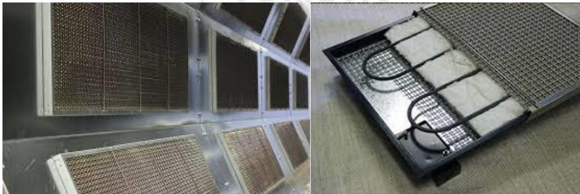
Figura 2.11: Paneles catalíticos infrarrojos instalados (izquierda). Elementos internos del panel catalítico (derecha).
