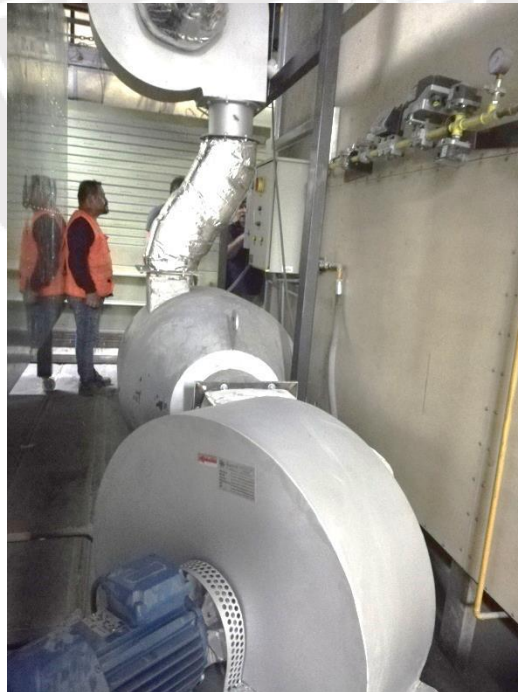
Figura 6.7: Sistema de circulación de gases calientes (generador de gases + ventiladores)
