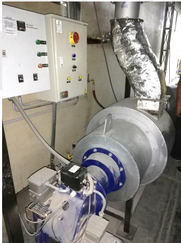
Figura 6.2: Generador de gases calientes.
