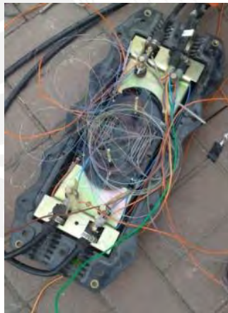
Fig. 2. Caja de transmisión óptica en mal estado
